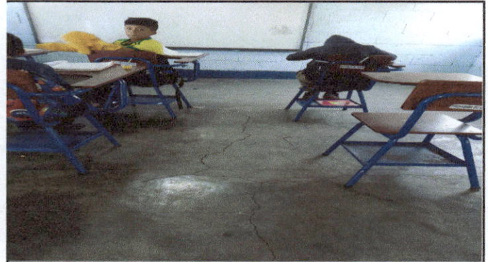
Foto 2: Piso en mal estado
