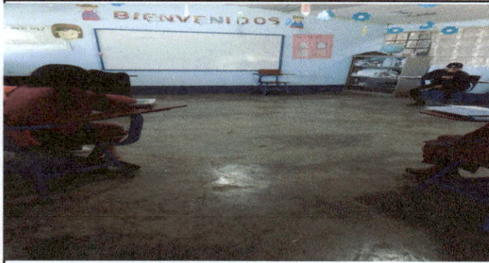
Foto1: Piso en mal estado
