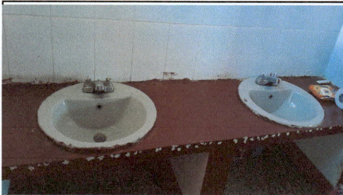
Foto 3: Grifo en mal estado
